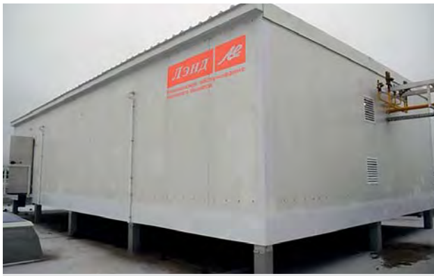
Рис. 3. Машинное отделение на крыше здания торгового комплекса
