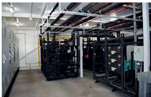
Рис. 2. Ресиверные станции Elementum для транскритической централи отечественного производства
